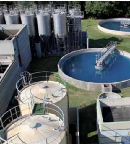
Endüstriyel atıksu arıtma tesisleri
